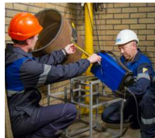
Сварочный пост управления аварийно-восстановительных работ. Специалисты Инженерно-технического центра выполняют подготовку к радиографическому контролю
